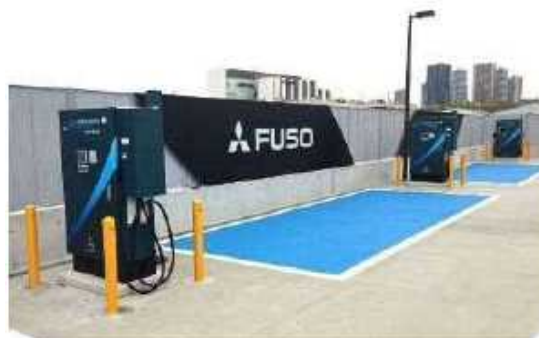
図 電気トラック用急速充電設備 (三菱ふそうトラック・バス(株)川崎工場内)
