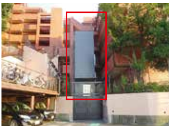
1～3階用の新設エレベーター
