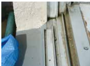
サッシの老朽化は 雨水の浸入につながった
