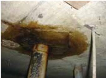
工事前、雑排水管の漏水
