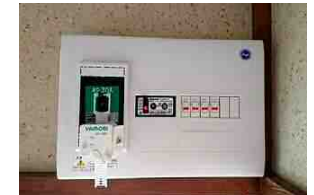
自治会集会所に設置した感震ブレーカー
