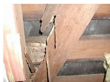
仕上げ材撤去後、 蟻害を確認
