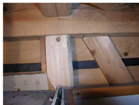
柱頭柱脚接合金物なし(診断時)
