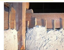
壁上端が施工未了
