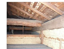
壁上端が施工未了(左)室内 壁上端まで施工(右)
