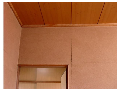
内外壁クラック
