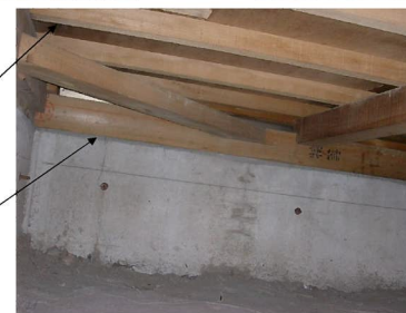
基礎クラック
