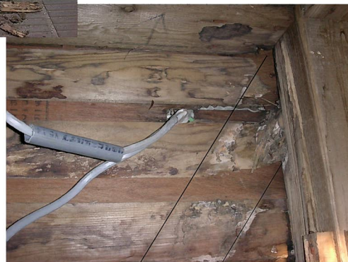
蟻害により筋交いが無くなった
