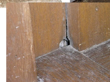
腐朽と蟻害による被害
