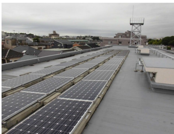
（屋上に設置された太陽光パネル）
