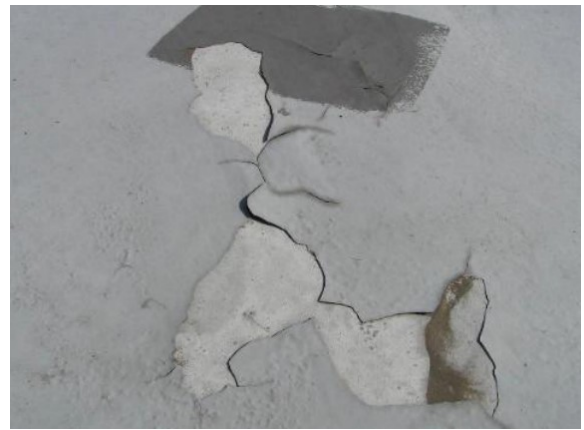
写真 2.1.2 防水層の破損の事例
