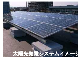
太陽光発電システムイメージ 出典：川崎温暖化対策推進会議HP
