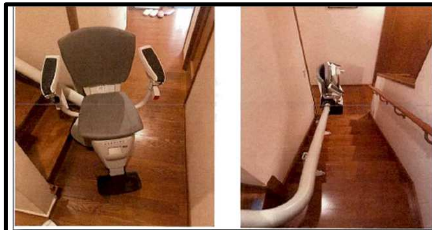
←階段昇降機設置例 （高齢者住宅改造費助成事業）
