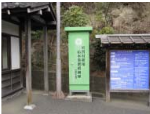
【給水装置格納庫(民家園前)】
