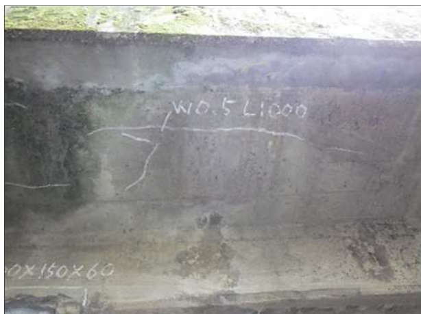
写真6-8 コンクリート床版のひび割れ(中原区 伊勢橋)
