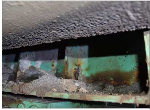
写真6-7 鋼桁の亀裂・腐食(多摩区 稲生跨線橋)
