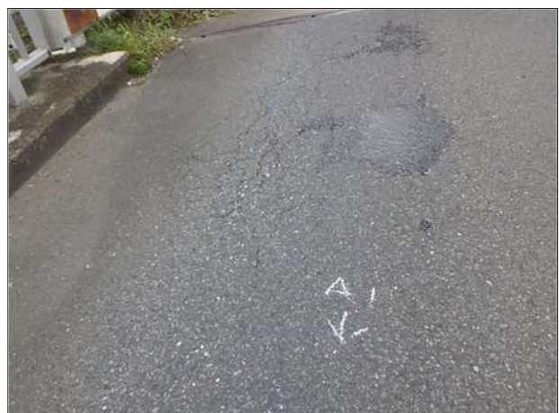
写真6-9 舗装の異常(麻生区 仲村橋)
