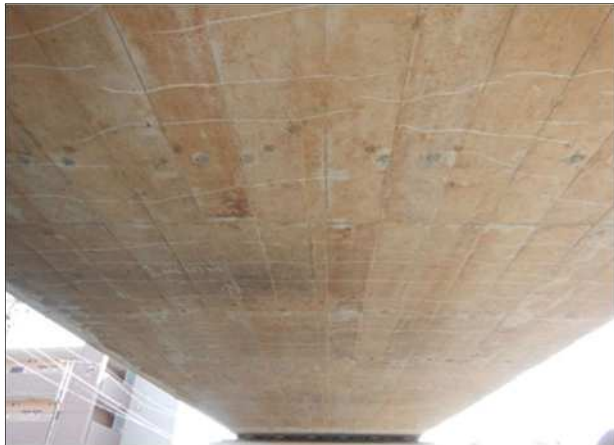
写真6-4 コンクリート床版橋(中空床版橋)のひび割れ(麻生区 岡上跨線橋)
