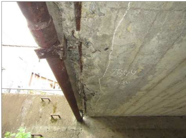
写真6-6 コンクリート桁の剥離・鉄筋露出(中原区 家内橋)
