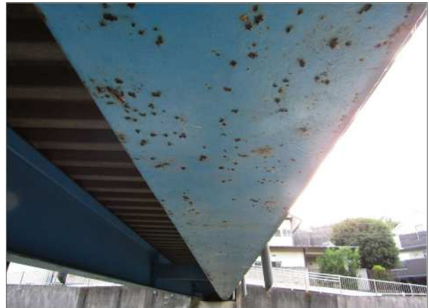
写真6-5 鋼桁の防食機能の劣化(中原区 井田桜橋)
