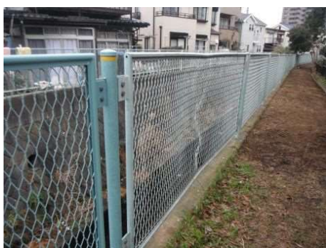
図 6.13 転落防止柵破損状況
