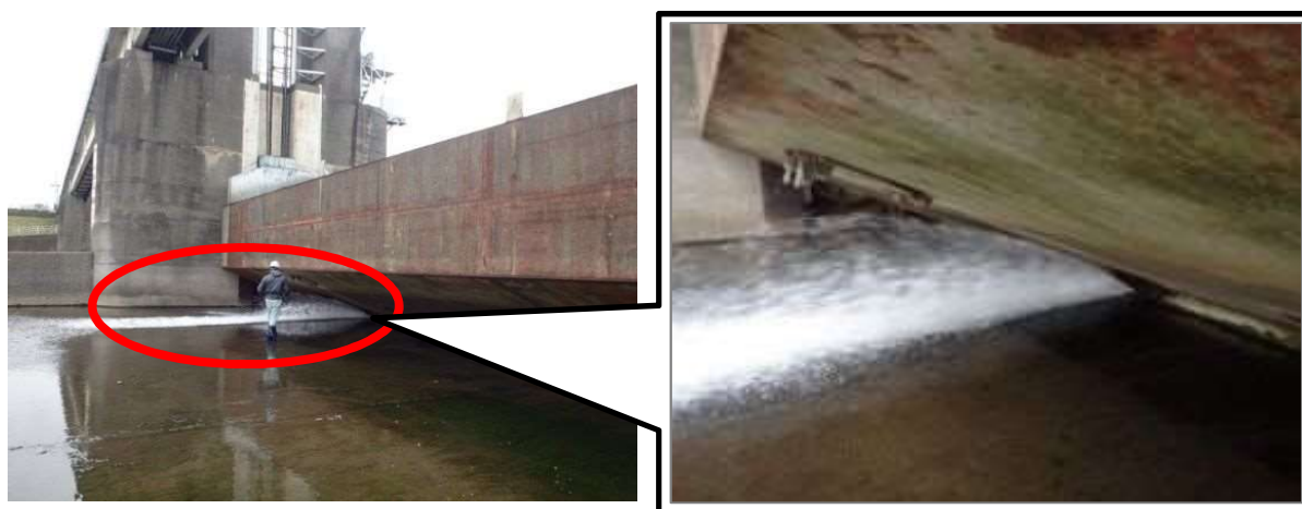
図 3.23 機械電気設備の劣化状況(上河原堰堤の扉体部分における水密不良)
