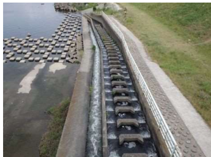
図 14.28 上河原堰堤の魚道(多摩区)
