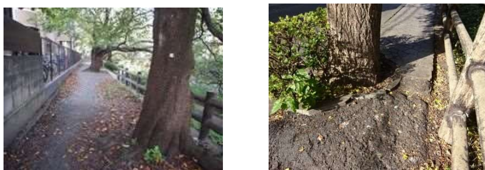
図 3.25 歩行者の通行の支障となっている様子 (左:二ヶ領用水宿河原線、右:二ヶ領本川上河原線)
