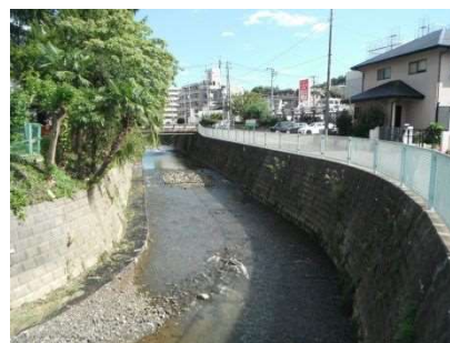
図 14.25 麻生川(麻生区)
