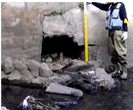
図 3.20 老朽化による護岸背面の空洞
