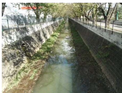
図 14.5 麻生川(麻生区)
