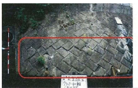
図 6.1 護岸のはらみ出し
