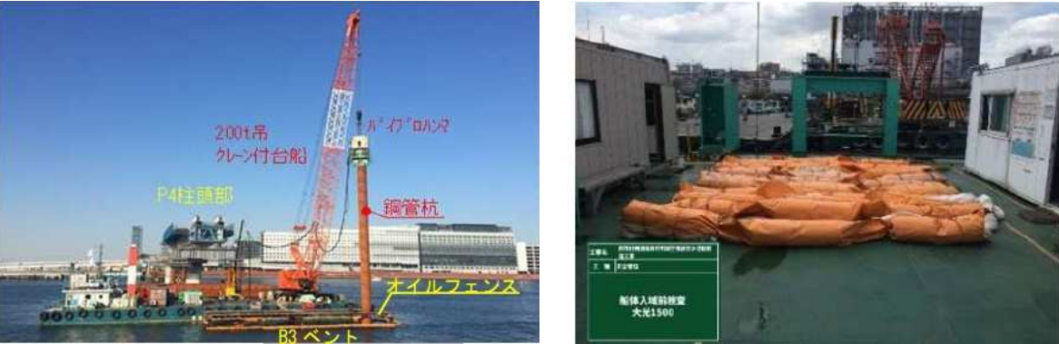
写真 2-24 オイルフェンス（左：展開状況、右：常備状況）
