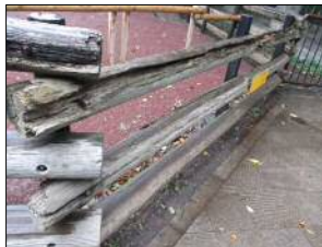
小動物舎の囲いの破損
