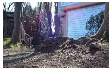
未舗装部の根上り
