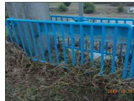
写真:扉体上部状況(台風後)
