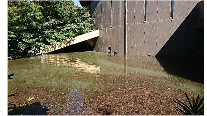
図12 地階の駐車場の水没状況
