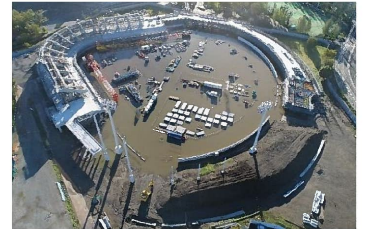
図6 硬式野球場の浸水状況
