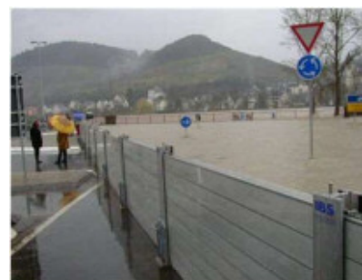
防水壁（設置事例）
