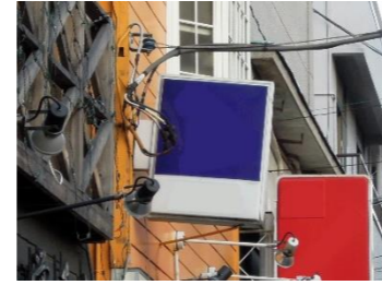
危険な状態の看板の例 (出典「屋外広告物の安全点検に関する指針」 国土交通省都市局公園緑地・景観課 平成29年7月)
