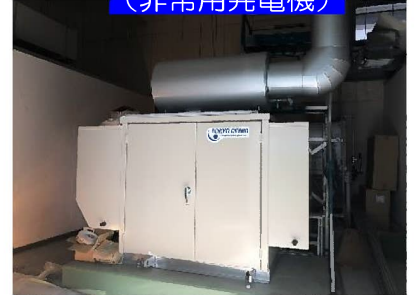
▽ ポンプ場内部の写真 (非常用発電機)
