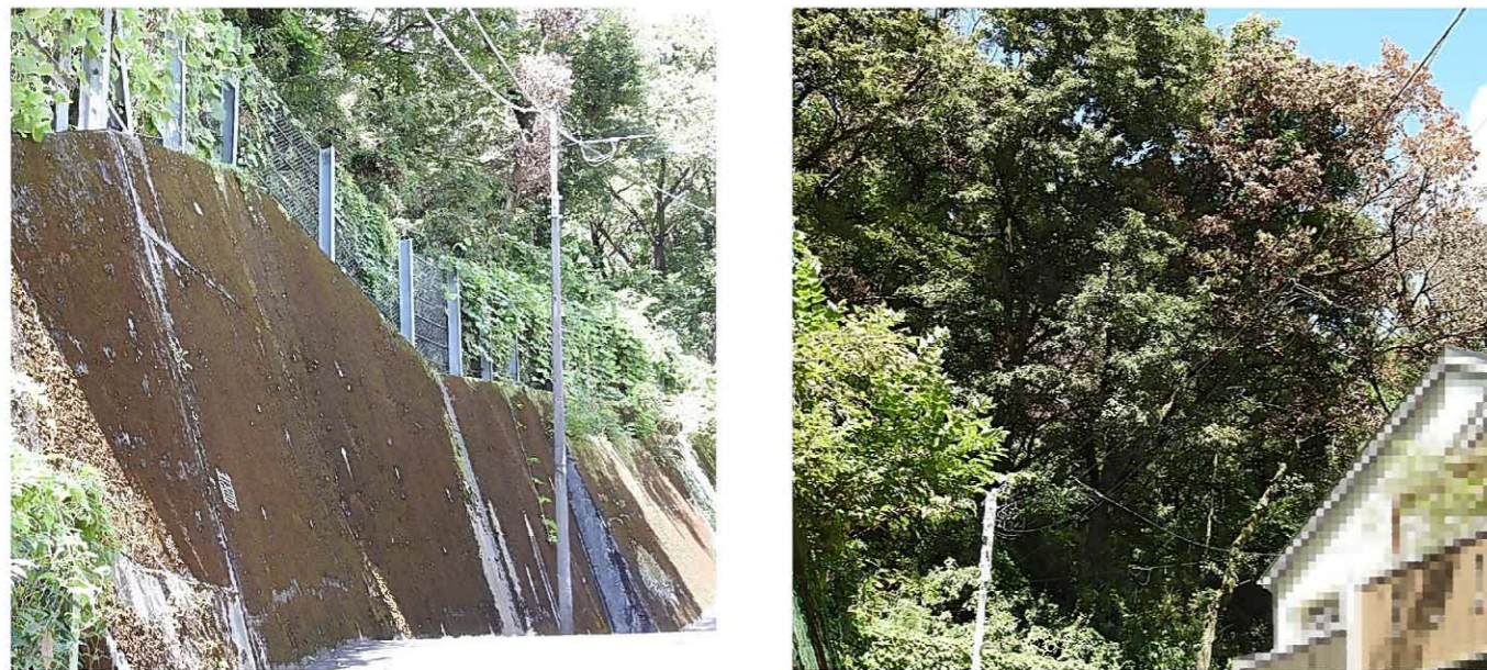
写真-13. 東生田2丁目地区、生田緑地の境界線に沿って昭和62年度急傾斜地崩壊対策工事として県により整備されたコンクリート張工（左）、コンクリート張工の上部に位置し隣接住宅に近接するナラ枯れ樹木（2022年9月6日撮影）（右）
