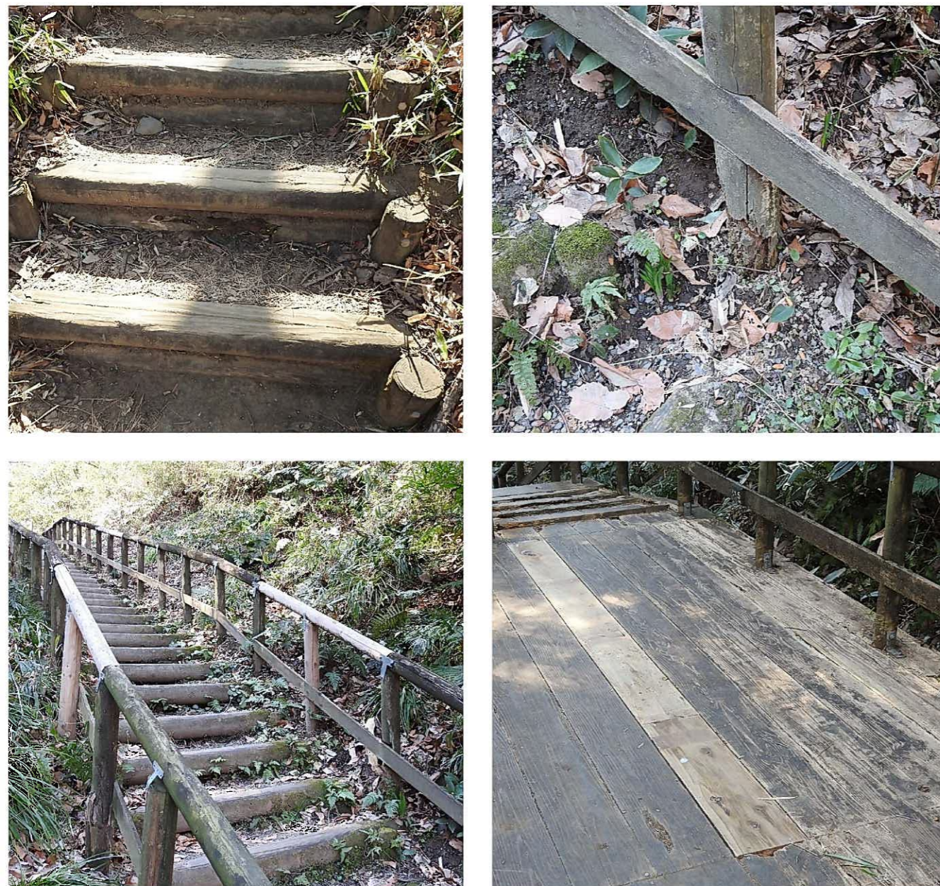
写真-14. 生田緑地の木製工作物腐朽状況および補修状況
