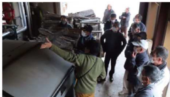
温浴施設の薪ボイラー
