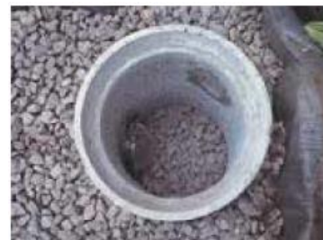
雨水浸透ます
