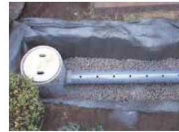
雨水浸透トレンチ
