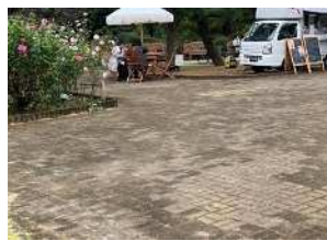
鑑賞環境の悪化 (舗装の老朽化)
