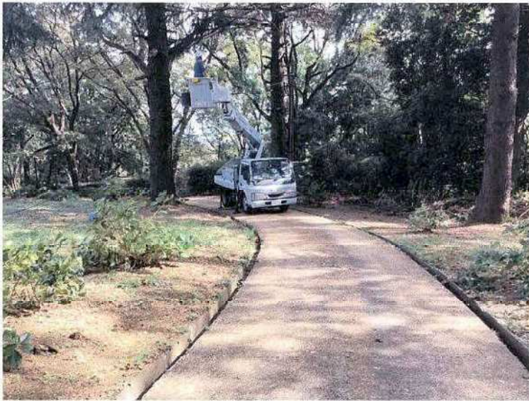
中間柱 ～引込柱 配線状況
