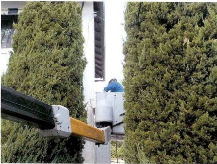
引込口 配線状況
