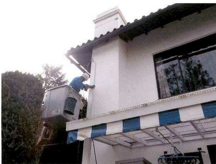
引込口 配線状況
