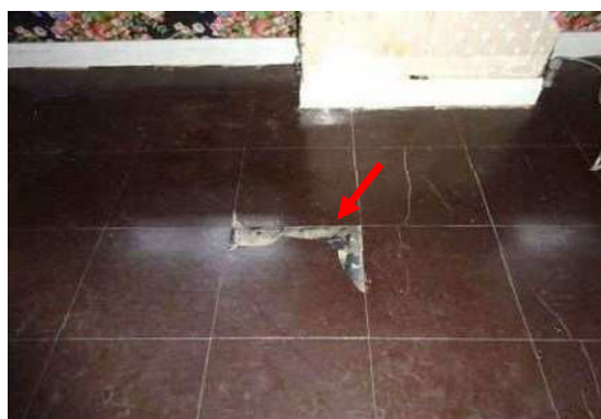
【2F 寝室B】 一部に損傷(割れ)が見られる
