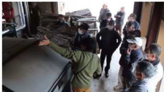
温浴施設の薪ボイラー
