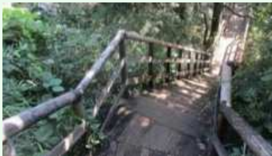
老朽化した木道
