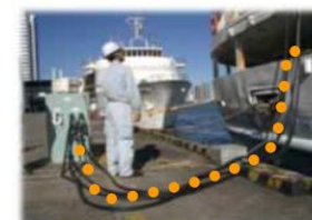
電力供給設備
