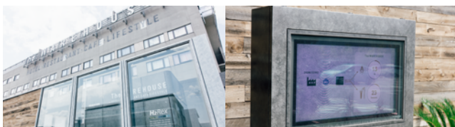
東急 REI ホテル敷地内にある純水素燃料電池『H2Rex™』
