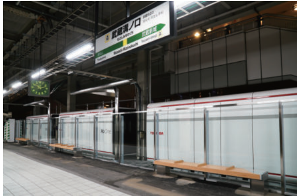
JR南武線武蔵溝ノ口駅構内のH2One™
