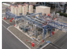
川崎脱水素プラント
