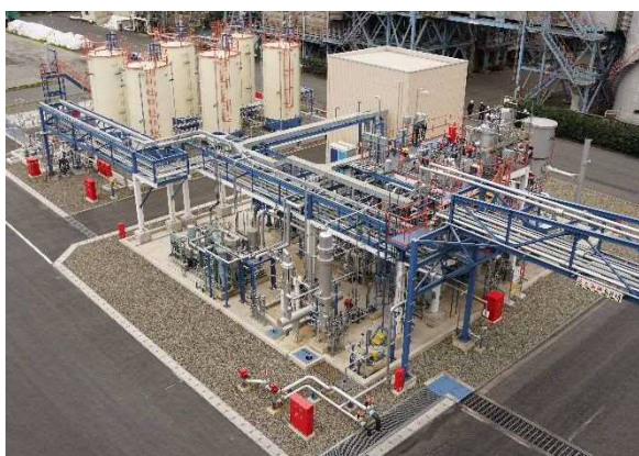
東亜石油(株)内の脱水素プラント（AHEAD 提供資料）
