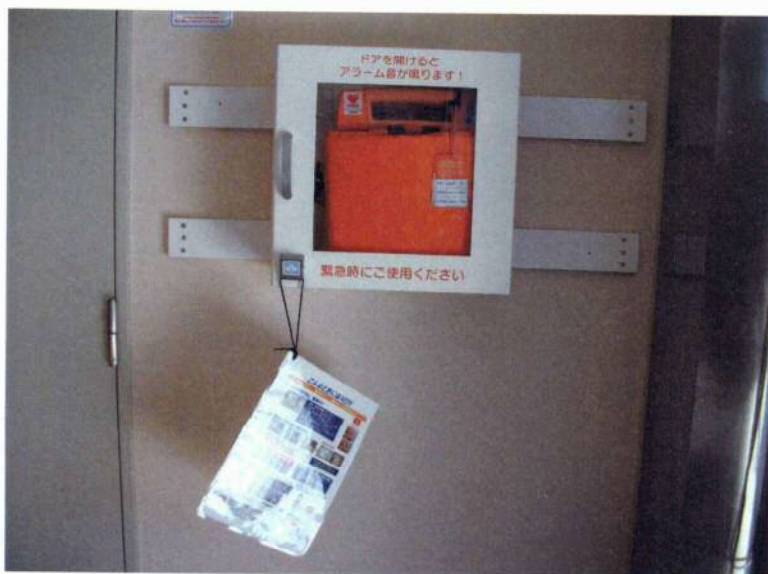
<写真14> AED設置
