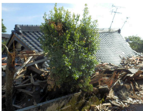
（益城町の倒壊家屋）
