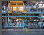
ドラム缶出荷設備
