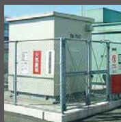
自家発電装置
