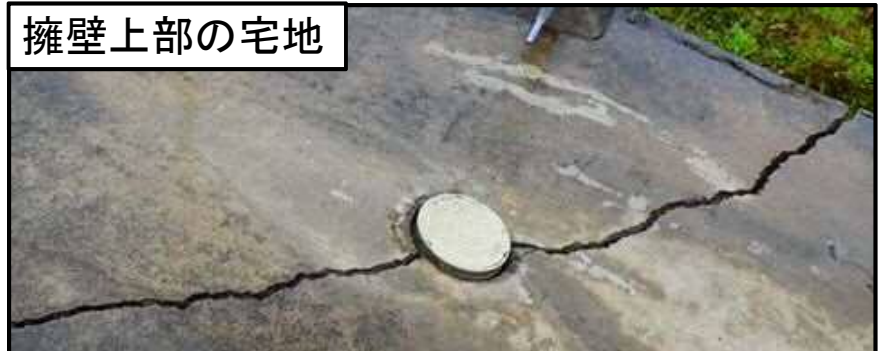
擁壁のクラック幅
