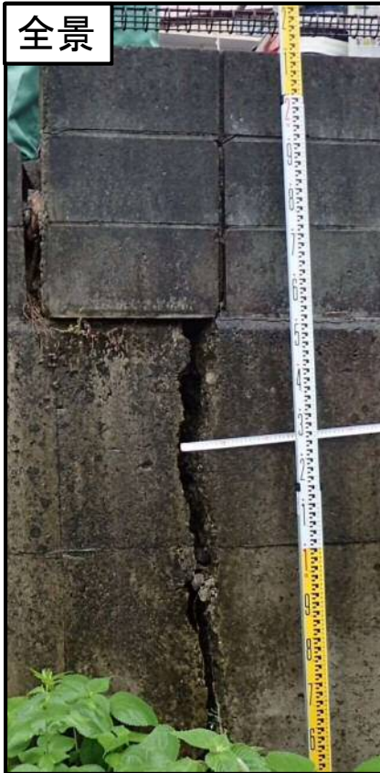
擁壁のクラック幅
