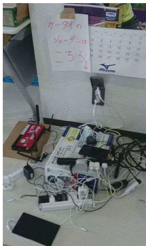
6 携帯電話の充電設備も設置
