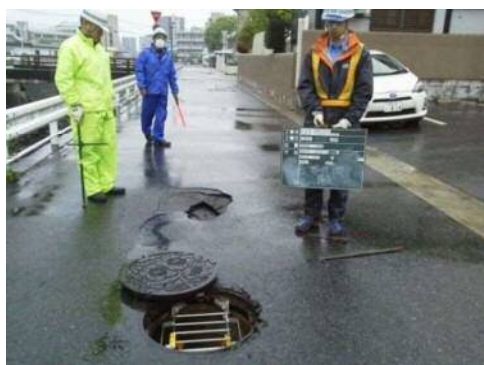
道路陥没箇所の状況確認
