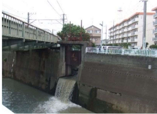
図 7-4-1 大丸用水接続部の水門
