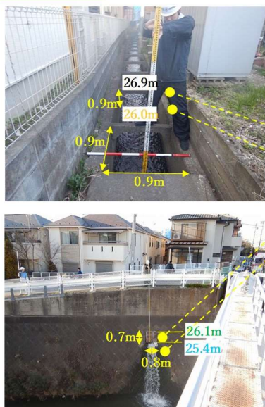
【吐き口部状況写真】
