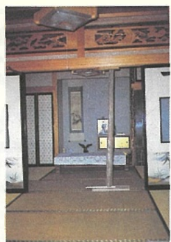
宮城県沖地震による被害
