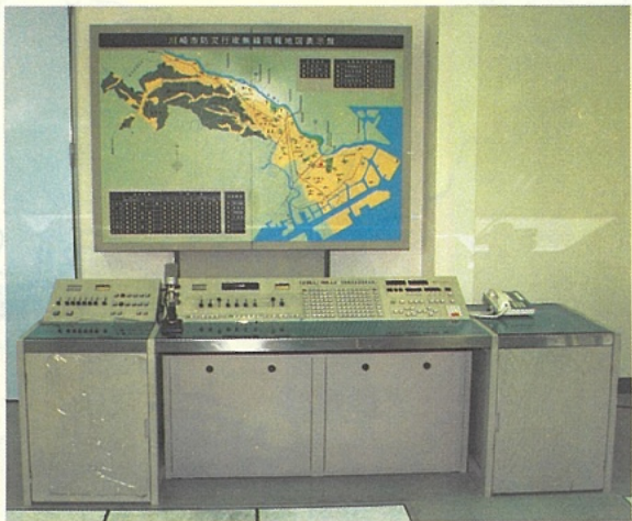
同報無線操作卓(無線統制室)
