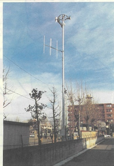
同報無線屋外受信機(新城小学校)
