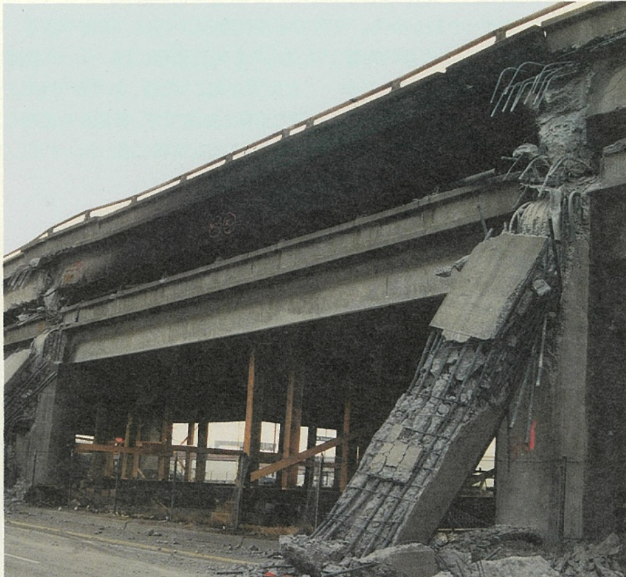
オークランド市の崩壊した高速道路
