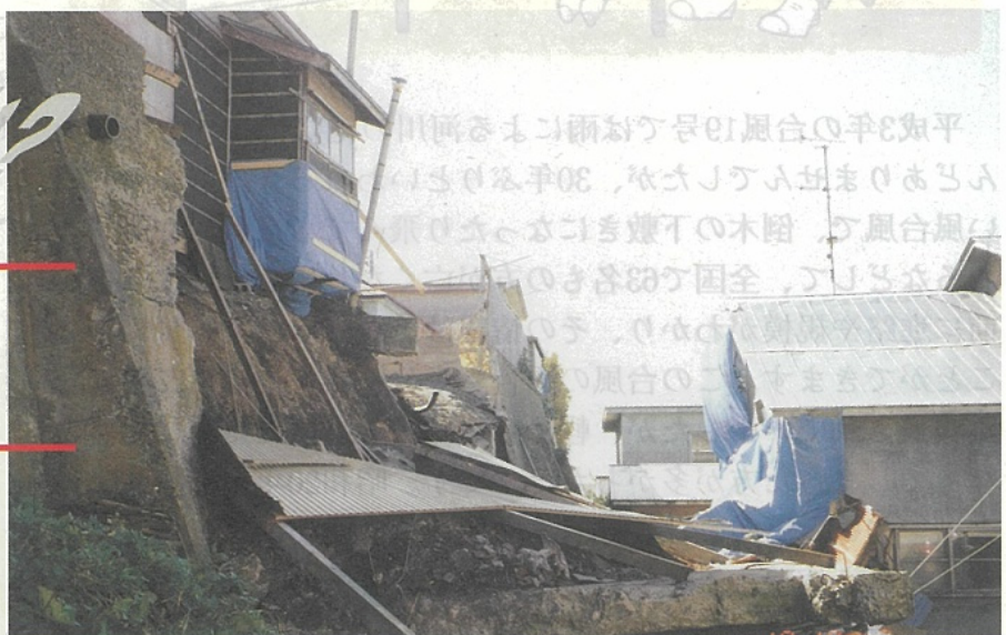
北海道東方沖地震による建築物の被害
