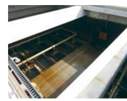
省エネ型浄水システム
