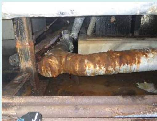
写真② 配管脱落事故
