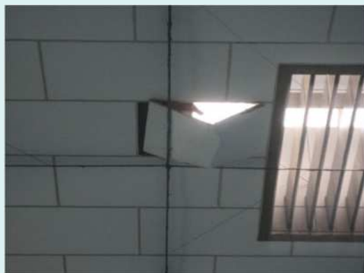
写真① 天井損傷
