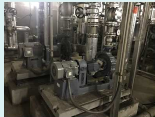
写真③ 高温水循環ポンプ
