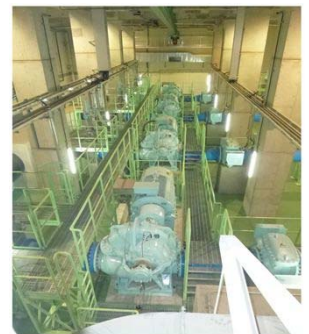
生田浄水場 工水2号送水管送水ポンプ
