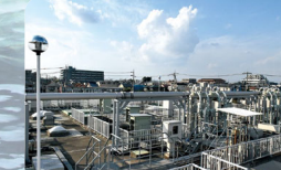
超高速凝集沈でん池 2
