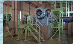
送水ポンプ設備 4
