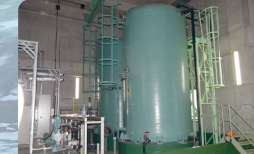
ポリ塩化アルミニウム注入設備 1
