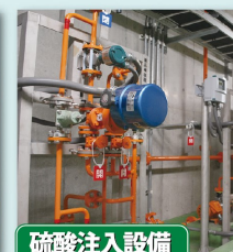
硫酸注入設備
