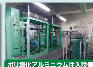
ポリ塩化アルミニウム注入設備
