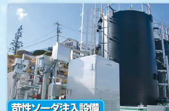
苛性ソーダ注入設備
