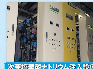
次亜塩素酸ナトリウム注入設備
