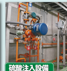
硫酸注入設備
