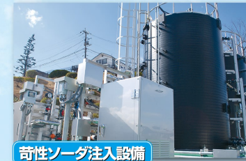
苛性ソーダ注入設備
