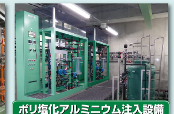
ポリ塩化アルミニウム注入設備
