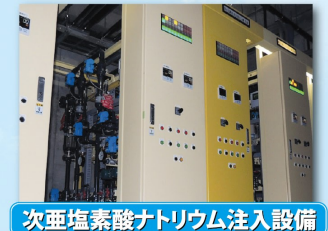
次亜塩素酸ナトリウム注入設備
