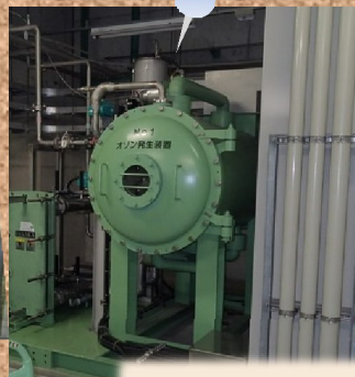
オゾン発生装置
