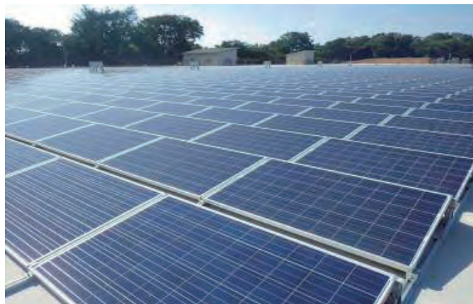
配水池上部を利用した太陽光発電
