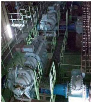
高効率な工水2号送水ポンプ
