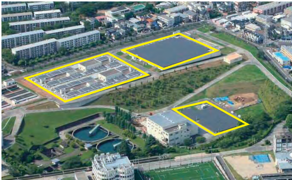
長沢浄水場太陽光発電設備
