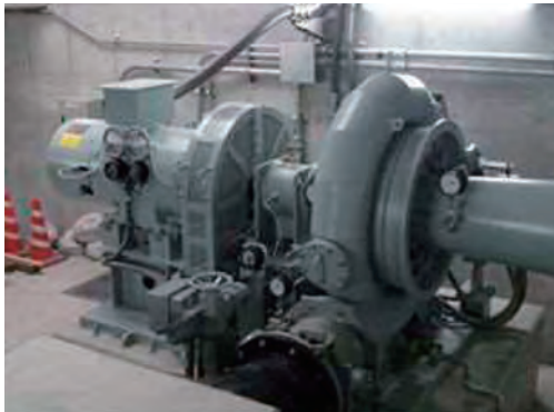
平間調整池小水力発電設備
