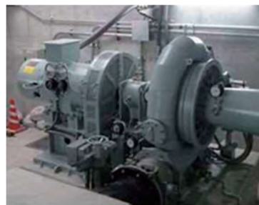
平間調整池小水力発電設備
