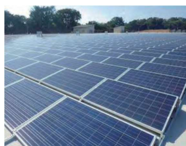
生田配水池上部太陽光
